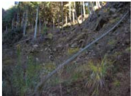
写真 9.2 崩壊した礫交じり土の法面
