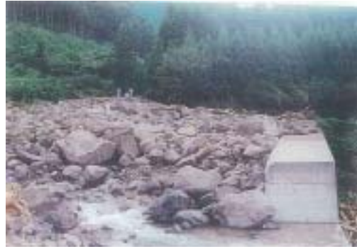
写真 1.4 成谷 堰堤により捕捉された土石
