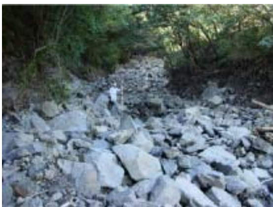
写真 - 1 上流 200m 石礫堆積状況
