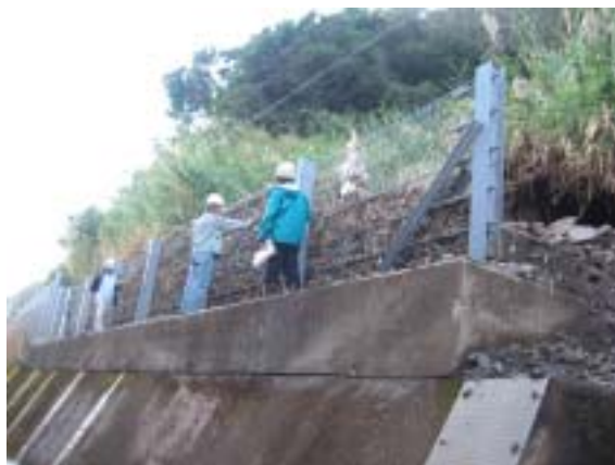
写真 - 2 落石防護柵により捕捉された土石
