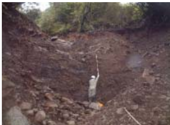
写真 - 4 流送区間の起点露頭。 路面より比高差90m、斜長200m地点。 壁状(H=7m)の泥岩露頭(CL~CM級、受け盤) 写真右側に崩壊跡。湧水無し。
