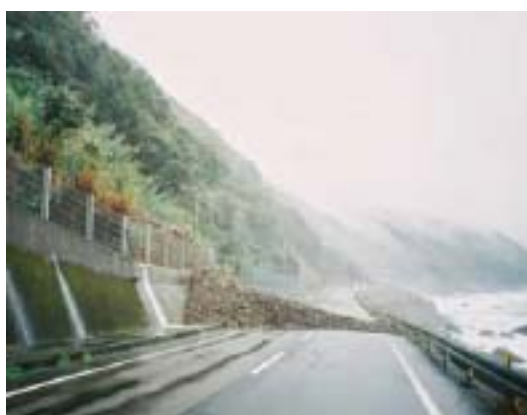
写真 - 1 路面被災状況 終点側（高知側）の落石防護柵基礎天端及び水抜き孔からの出水している
