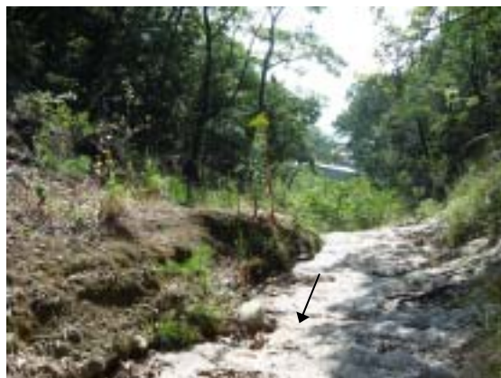
図 5.4 土石流により剥ぎ取られ基岩が露出
